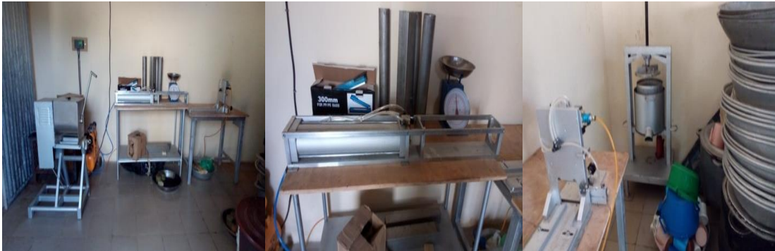
Photo 3 : Machines de production de savon de l'unité de Loukouk
