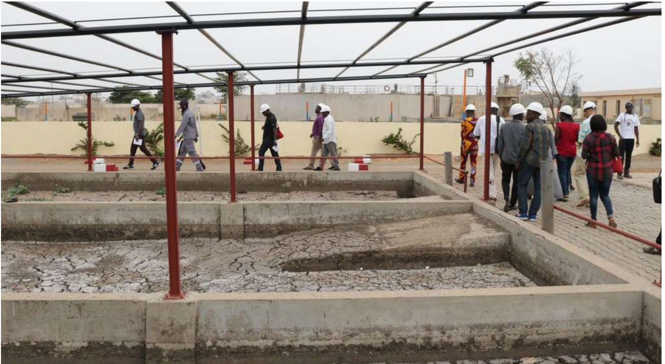
Usine de traitement de boues de vidange au Bénin.
